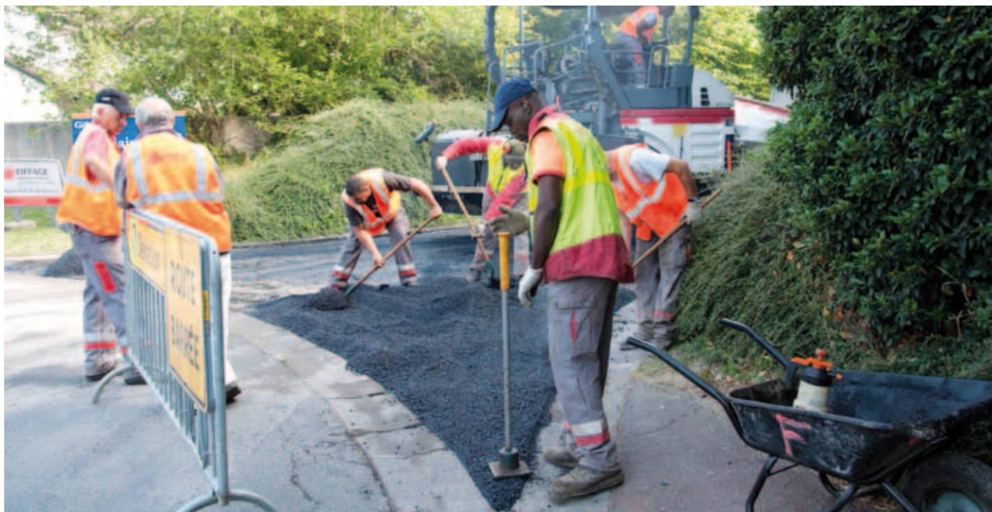
Les entreprises et les agents des services Techniques ont travaillé tout l'été.
