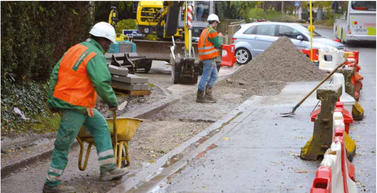
Une partie de la rocade de Frileuse sur le plateau de Chevry a fait l'objet d'une rénovation de la chaussée.
