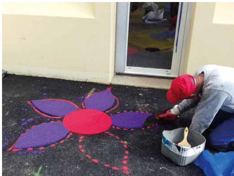
L'embellissement de la cour de la crèche Belle Image en cours de réalisation.
