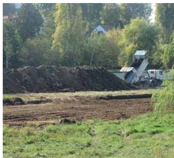
Le bassin de Gif-Bures a fait l'objet d'importants travaux menés par le SIAHVY fin 2018.
